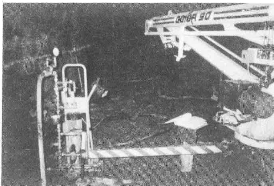
Figur 2.5 Pumputrustning samt skylift i transporttunneln
