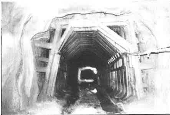
A. Träförstärkning, bockort
