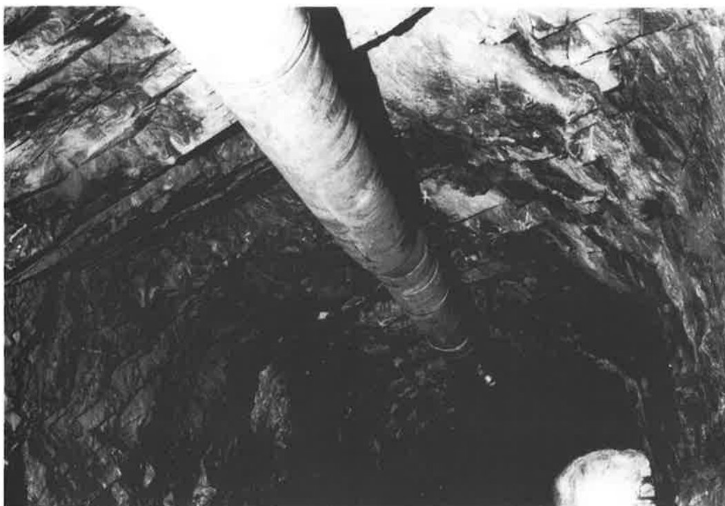
Figur 6 Sydostligt stupande sprickor i tunneltaket Foto: Lars Hansen.
