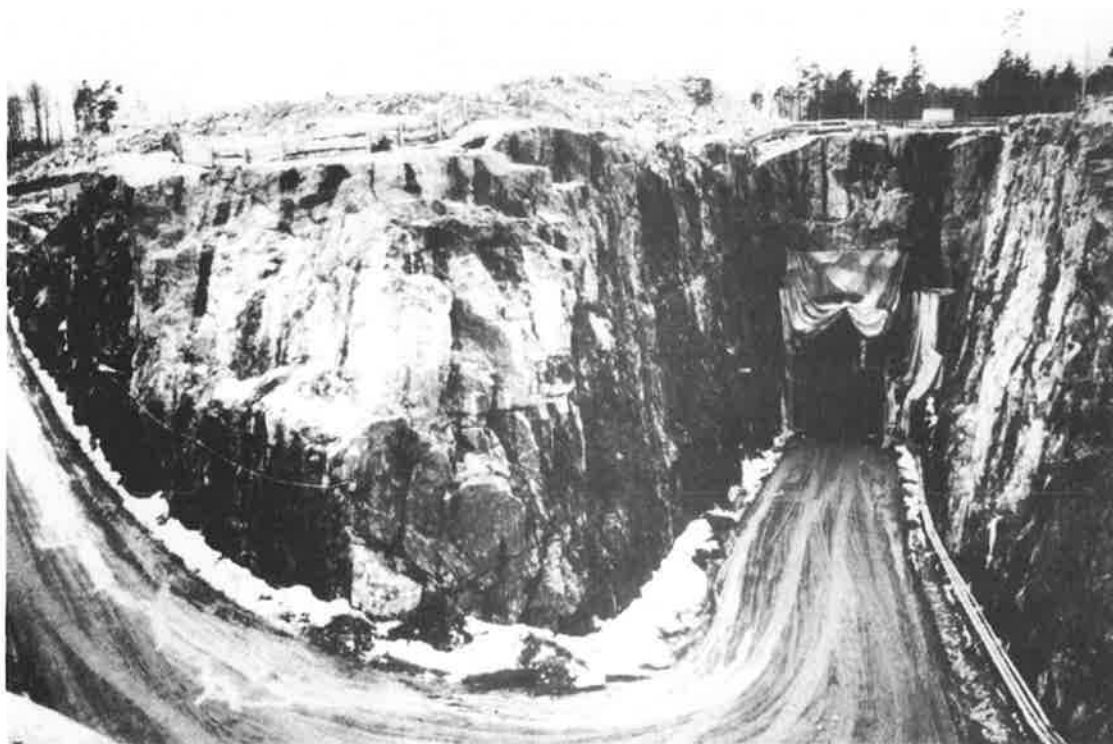
Figur 11 Utloppskanal med tillfartsväg. Foto: Lars Hansen.
