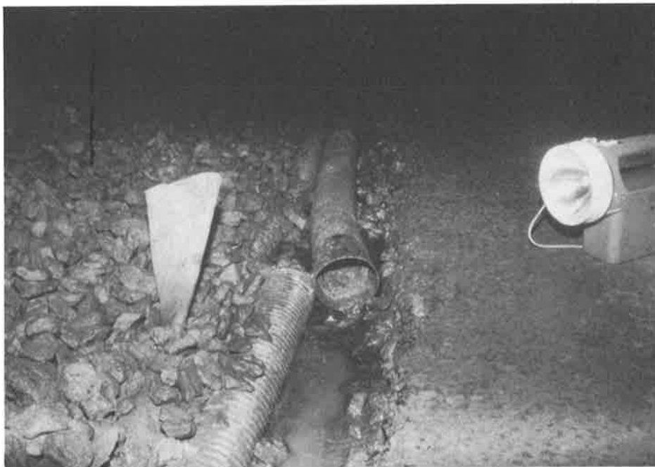
FIGUR 12 Sättningsskador orsakade av grundvattensänkning
