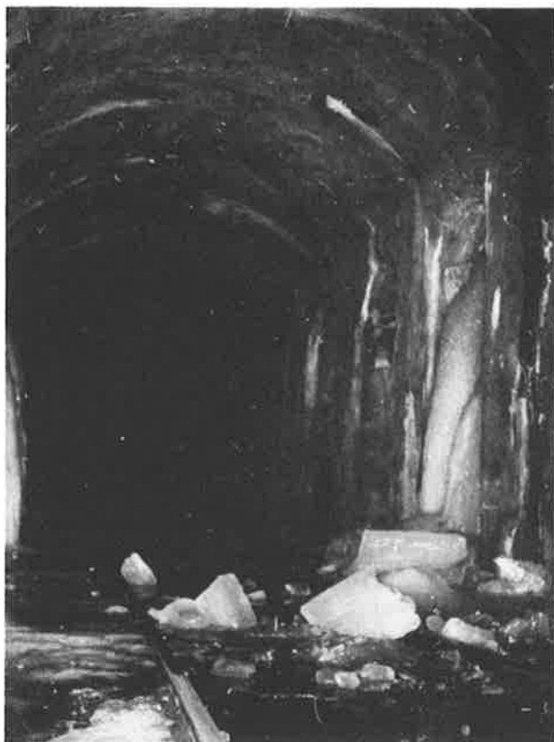
Fig 2. Isnedfall i Åmålstunneln Ice fall in the Åmål tunnel
