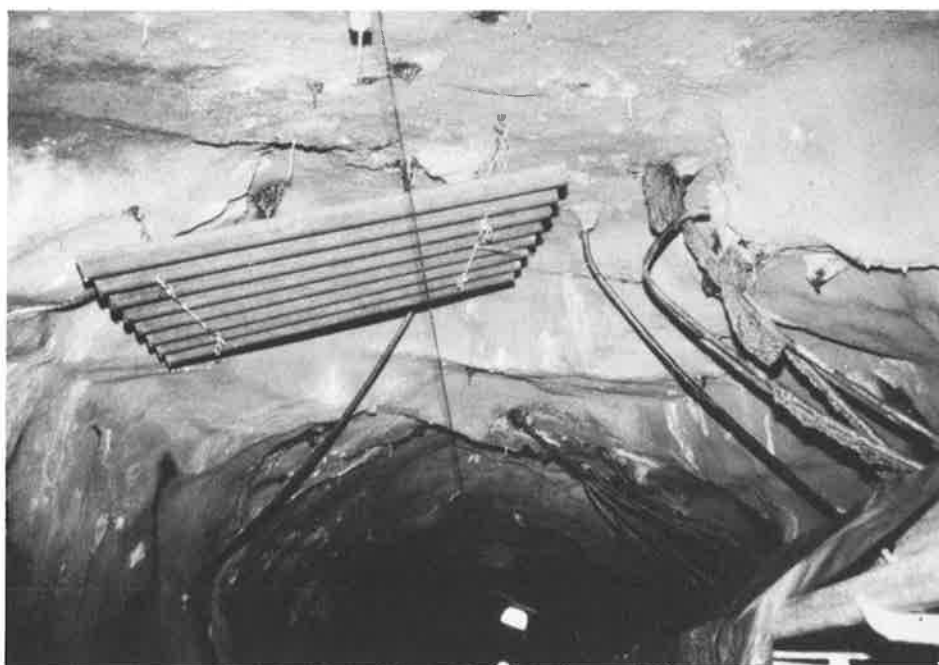
FIGUR 8 Dräneringsplåtar i tunnel
