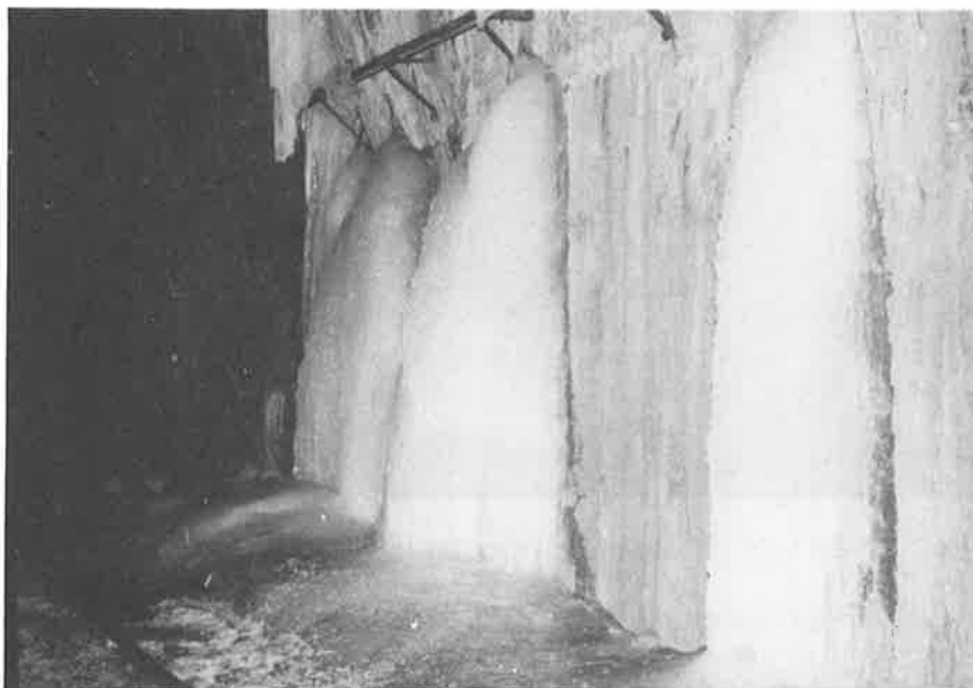
Fig 3. Issprängning av betong i Liljeholmstunneln Concrete, broken by ice, in the Liljeholmen tunnel
