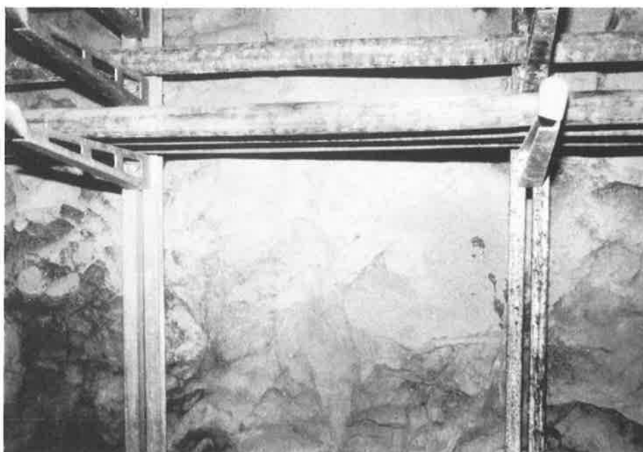
FIGUR 10 Rostande och icke rostande tunnelinredning Corrosive and none-corrosive equipment in tunnel
