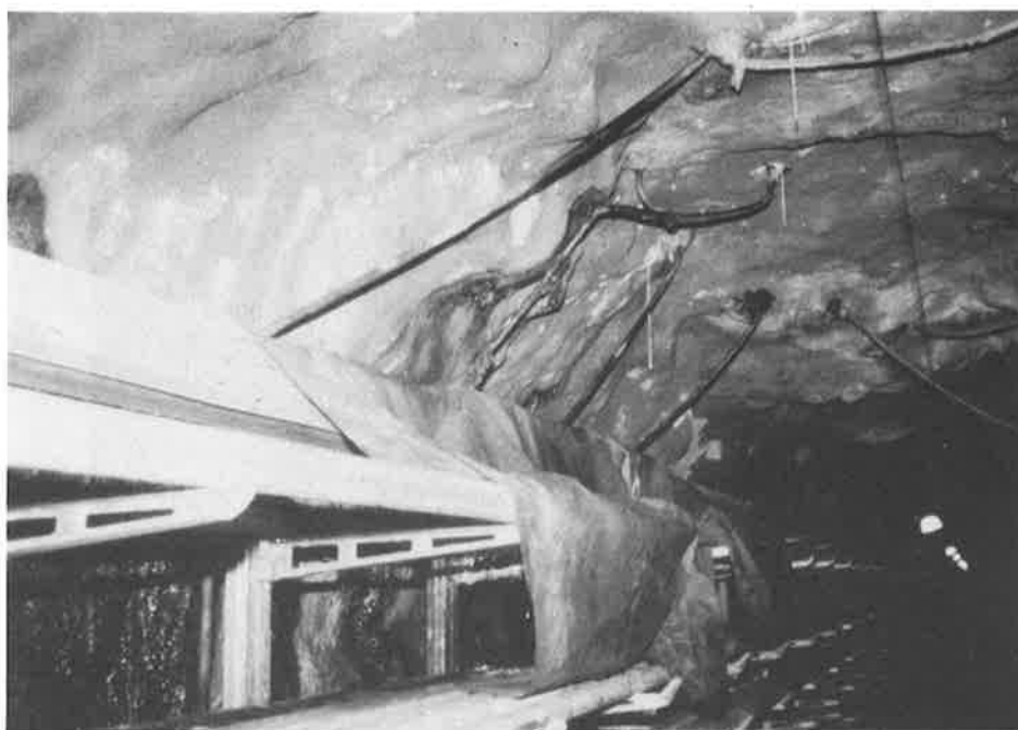
FIGUR 9 Skyddsplast över kablar Protective plastic covering cables
