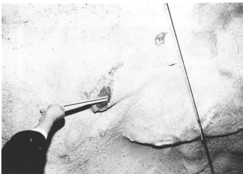
FIGUR 3 Avlossning av tunn sprutbetong Loosening of thin shotcrete
