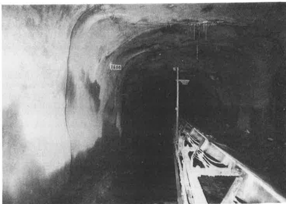
Bild 12. Sektion 1600. Sprutbetongen är alljämt intakt. Endast en smärre spricka.
