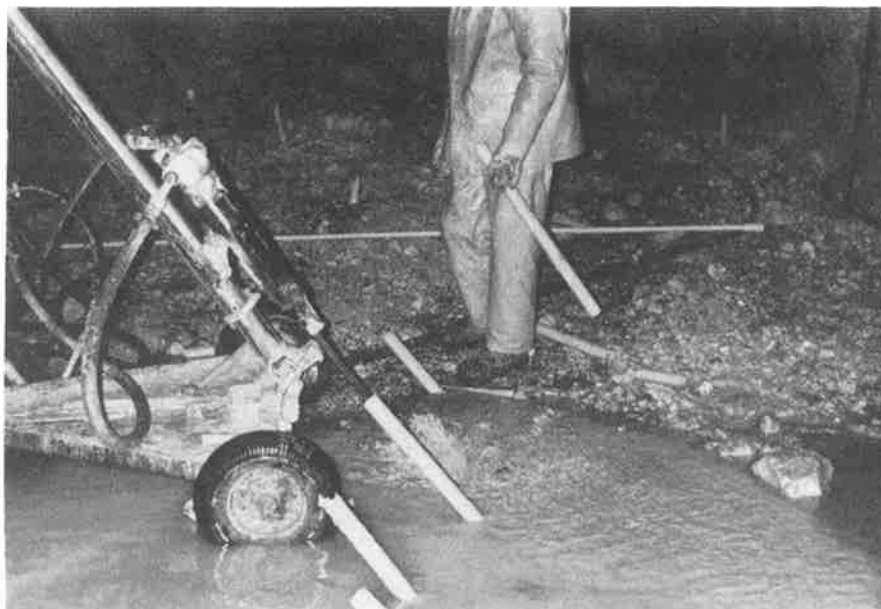
Bild 8. Trots förinjektering måste man ibland eftertäta läckande zoner genom injektering av tunnelgolvet.
