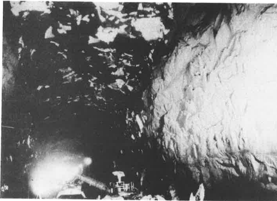
Fig. 1 Sektion 2+500 efter uttagning av pallen. Observera skrotningsfläckarna i taket. Section 2+500 after the excavation of the bench. Note the scaling spots in the roof.
