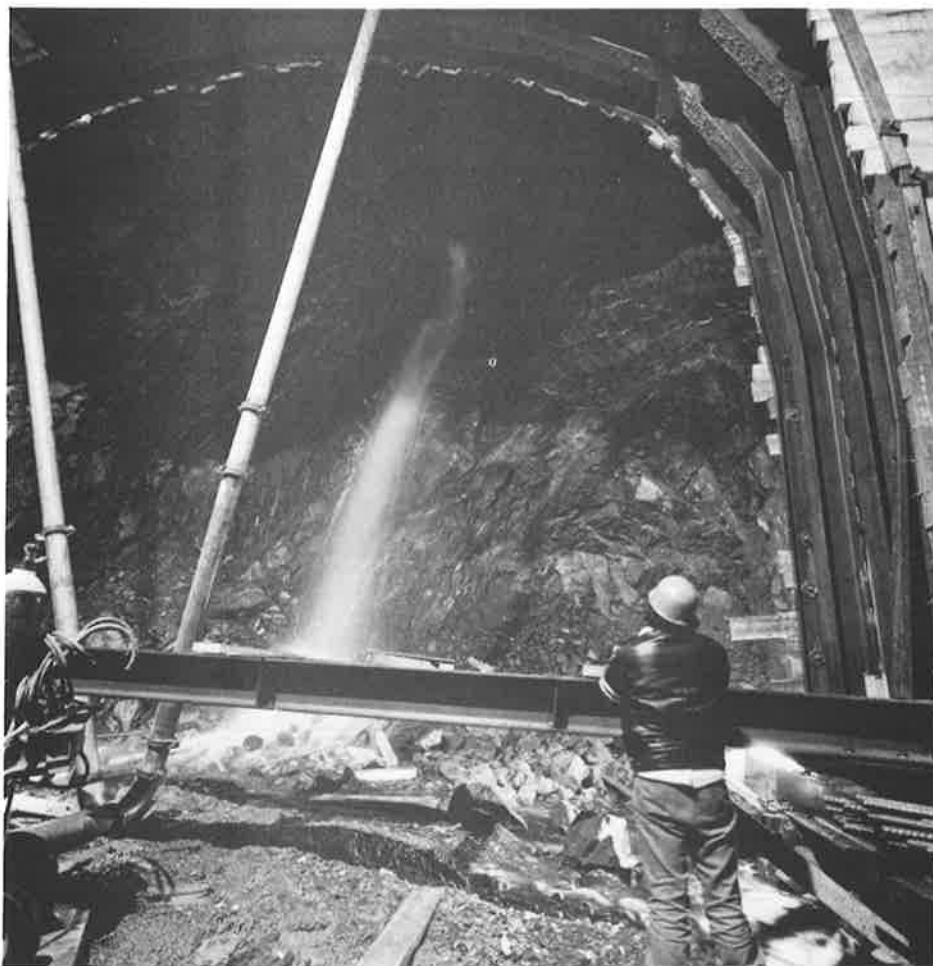
Figur 7. Distinkt vattenläckage i avloppstunneln. Vattenflödet är cirka 50 l/s. Foto av Ö. Eriksson.
